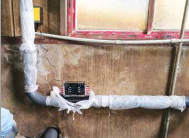
Vulcan S100, çamur susuzlaştırma makinesini arıtmak için kanalizasyon odasına kuruldu.
