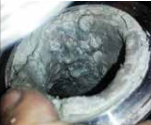
Vulcan kurulumundan önce: boru kireç birikintileriyle doluydu.
