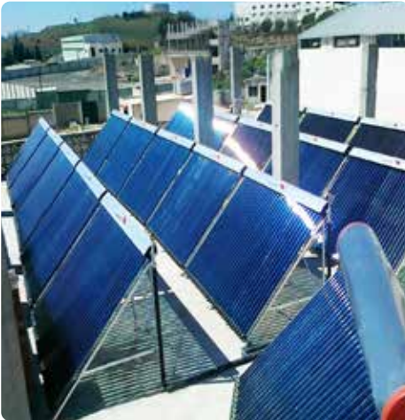
Bir apartmanın güneş enerjisi panelleri
