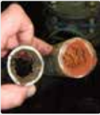
Boru tesisat sistemleri
